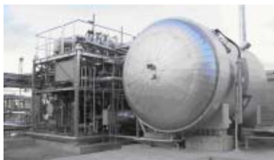
300kW級溶融炭酸塩形燃料電池 (MCFC) の商用型1号機 (中部電力(株) 新名古屋火力発電所構内)
