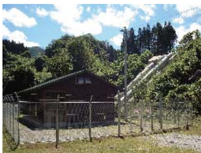
熊本県上益城郡の 小水力発電所
