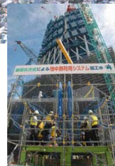
東京スカイツリー 地域冷暖房 (東武エネルギー・マネージメント/大林組・大成建設)
