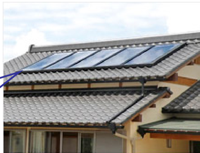
強制循環式太陽熱温水システム
