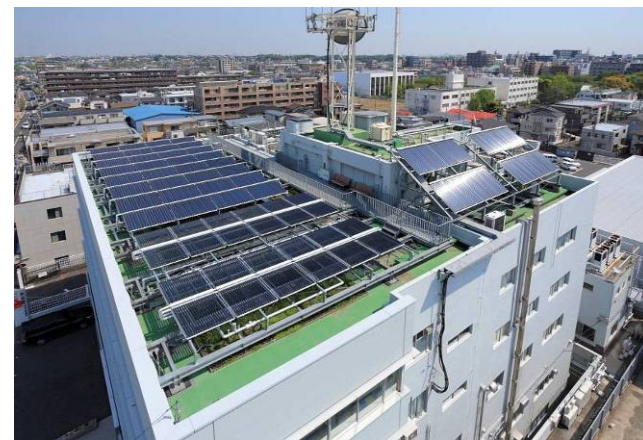
ソーラークーリングシステムの実証試験 (東京ガス 中原事務所)
