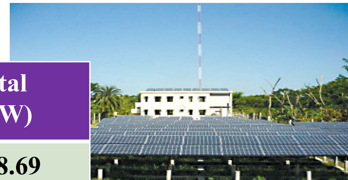
Solar Mini Grid
