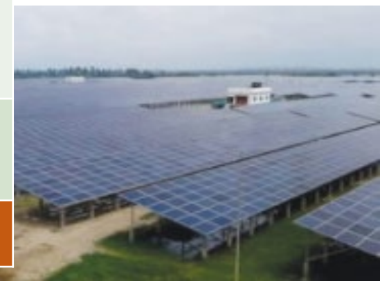
Grid-tie Solar Park
