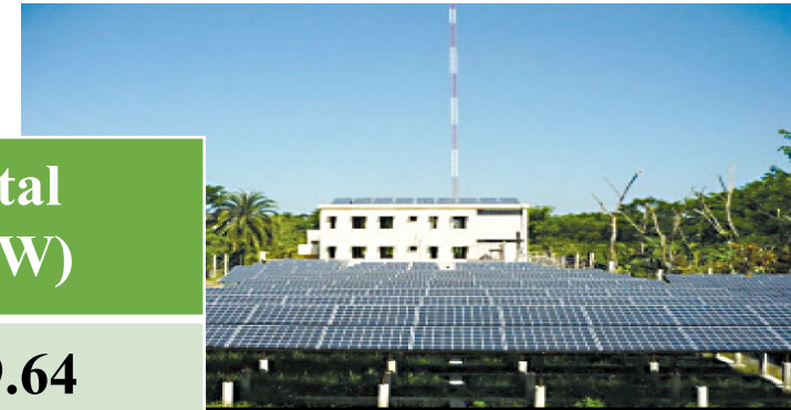
Solar Mini Grid
