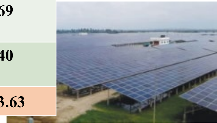
Grid-tie Solar Park
